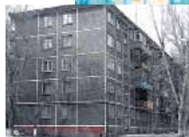
Рис. 4. Большие тепловые потери через ограждающие конструкции (г. Темиртау и Сарань)
