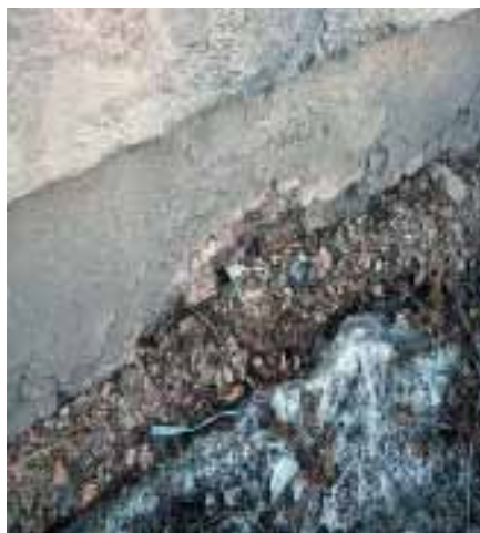
Рис. 1. Фрагмент фундамента жилого дома постройки 1963 г. (г. Караганды)
